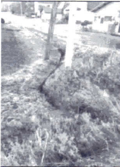
※ 豪雨による冠水被害を防ぐには日頃の水路の点検は欠かせない。
